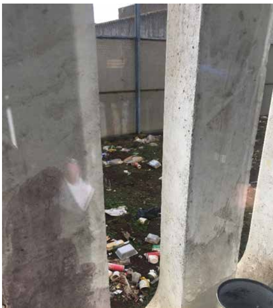
Détritus en pieds de bâtiment
