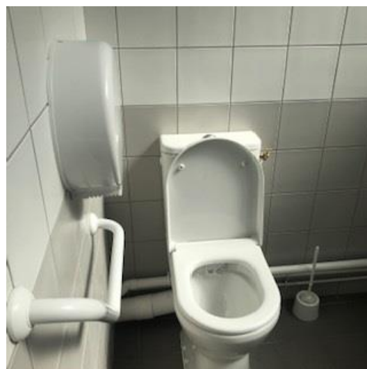
Les WC destinés au public
