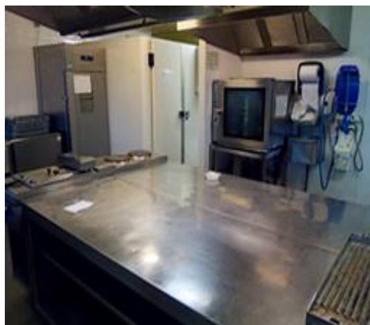
Les locaux techniques de la zone cuisine
