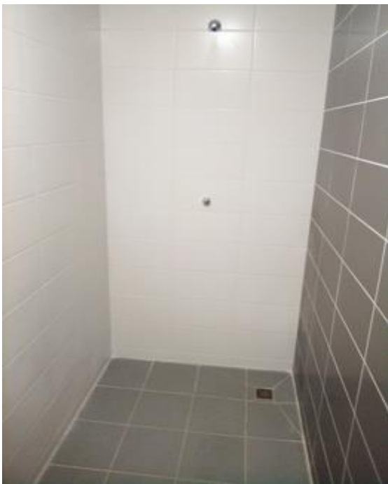
Cabine de douche
