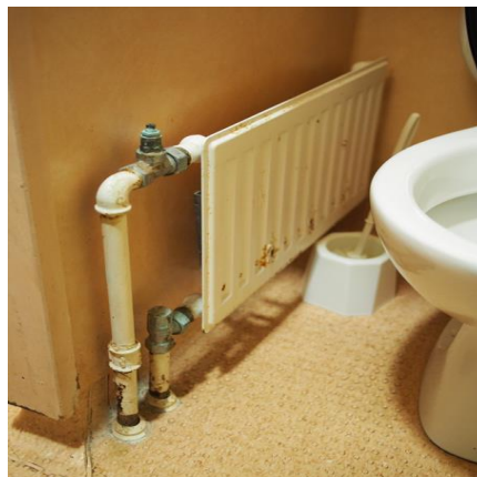
Chauffage vétuste et rouillé, dans la salle de bain d'une des chambres
