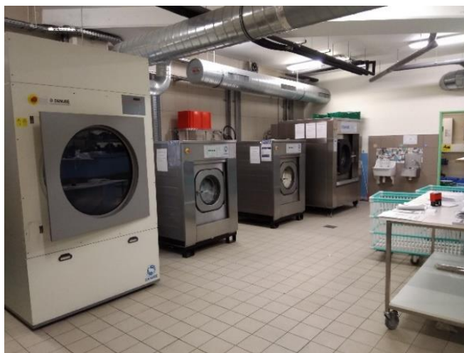
Zone de lavage et de séchage de la blanchisserie
