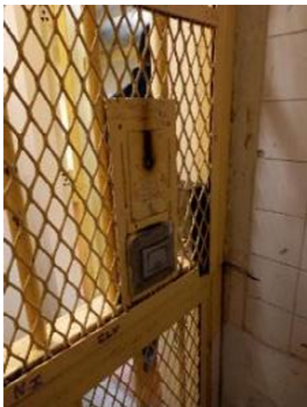
Allume-cigare ; derrière le métal déployé, bloc interrupteur et interphone
