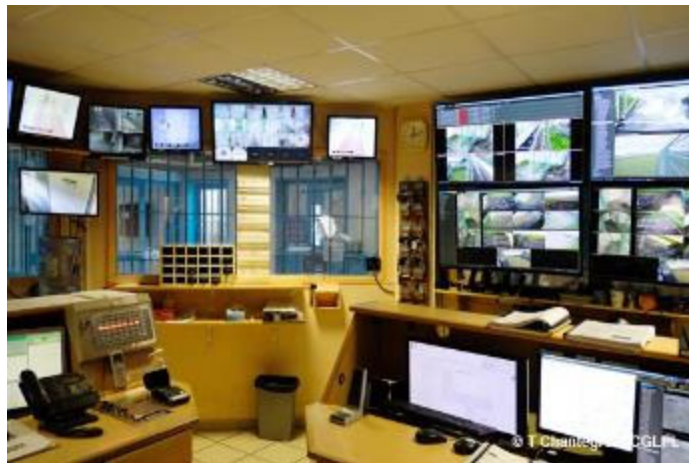
Vue partielle des écrans de surveillance du poste central et d'information (PCI)
