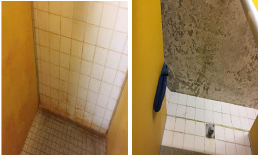
Douches du bâtiment B
