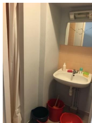
Les sanitaires d'une cellule du QMAF
