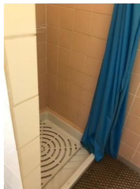
La douche du vestiaire
