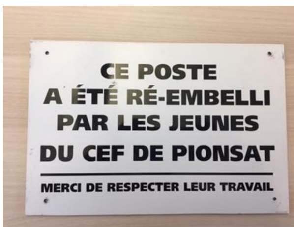
Panneau sur un transformateur rénové
