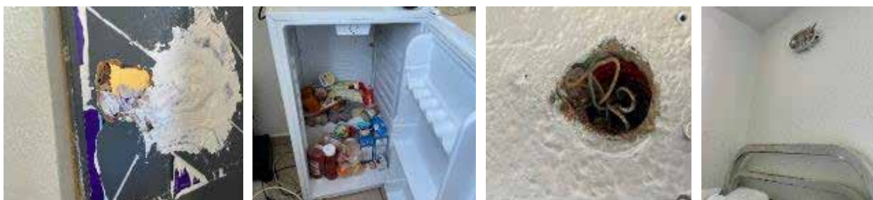
Cellule 1 : porte de WC percée, réfrigérateur sans clayette, emplacement pour liseuse ou liseuse HS
