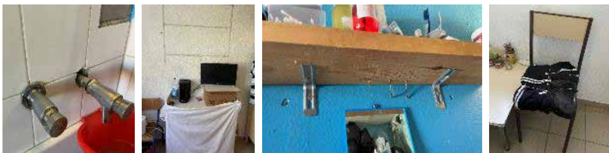
Robinetts branlants, étagères non-fixées au mur ou posée sans vis sur deux équerres, chaise cassée.
