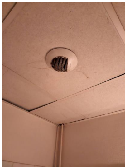
Conduit de VMC situé à proximité d'une chambre d'isolement
