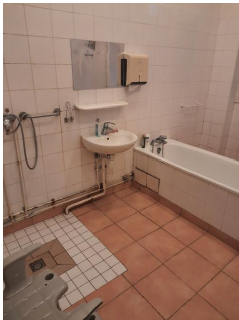
Vue d'une salle de bains et douche commune vétuste à l'unité Rosa Parks
