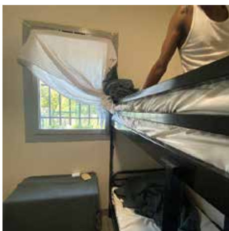
Absence de volet dans une chambre
