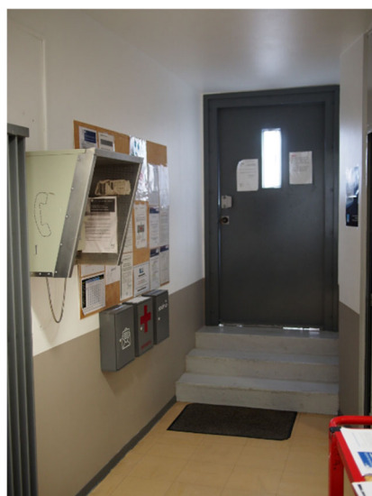
L'accès à la cour de promenade du QA des hommes, avec escalier et sans main courante
