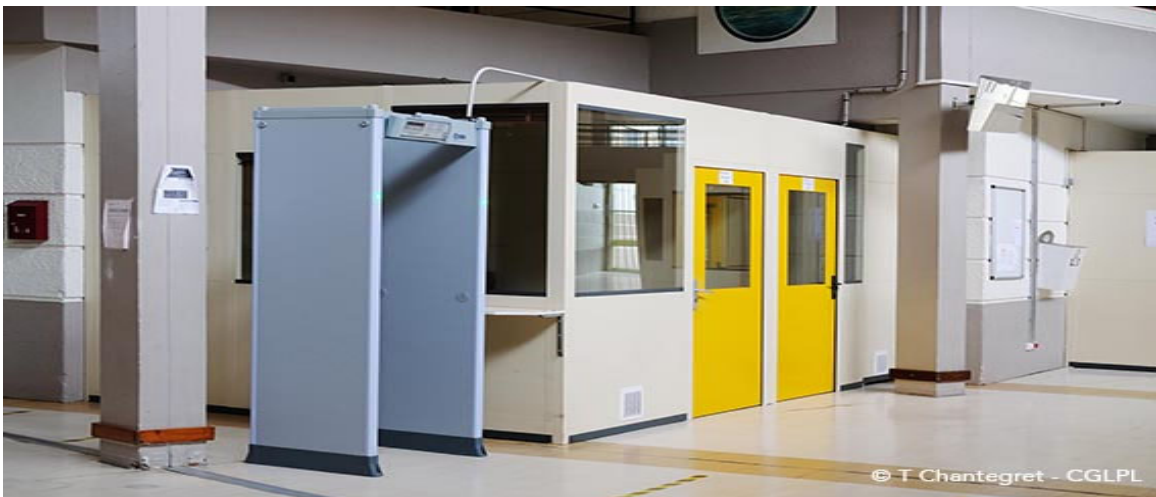
Un des deux portiques de détection dans « la rue », qui sécurisent l'accès à la détention
