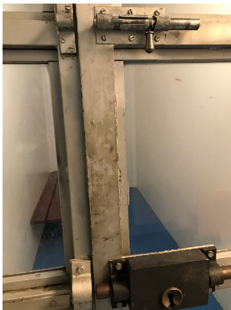
Huisserie crasseuse d'une cellule de garde à vue
