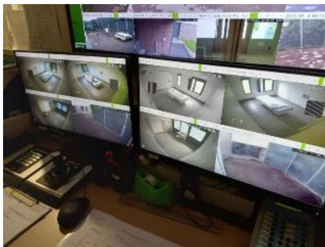
Images (sur les deux écrans du bas) des caméras de vidéosurveillance des deux espaces d'isolement
