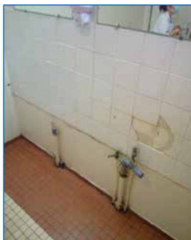
Lavabos supprimés, unité Daumezon
