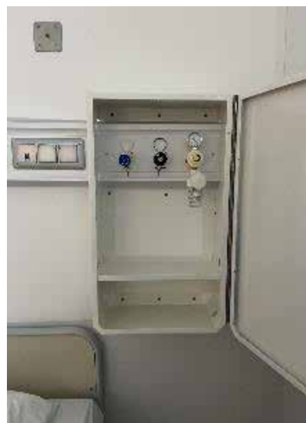
L'armoire contenant les accès aux fluides
