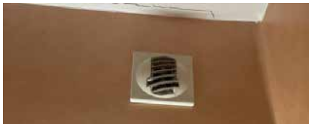
Bouche d'aération dans le local sanitaire d'une chambre
