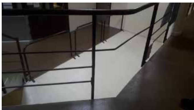
Barreaudage de l'unité 8
