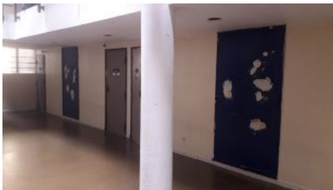
Portes des gaines technique de l'unité 7
