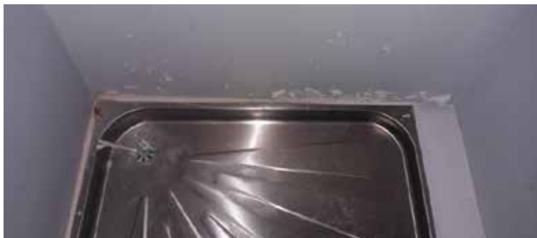
Peinture écaillée de la douche du LRA
