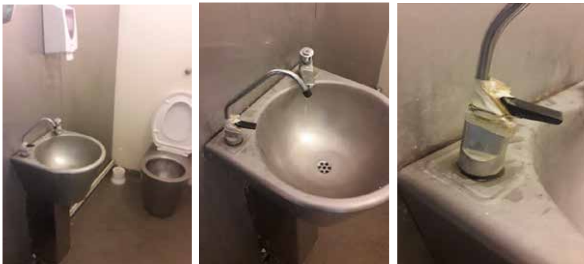
Robinet des toilettes réservées aux fonctionnaires du bâtiment modulaire, utilisé par les personnes privées de liberté lorsque le point d'eau de leur cellule n'est pas fonctionnel
