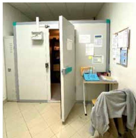
La chambre froide
