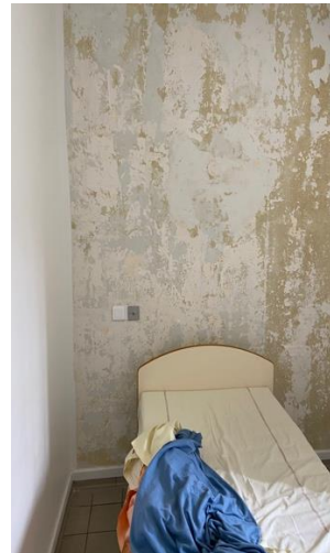
Chambre de surveillance dégradée
