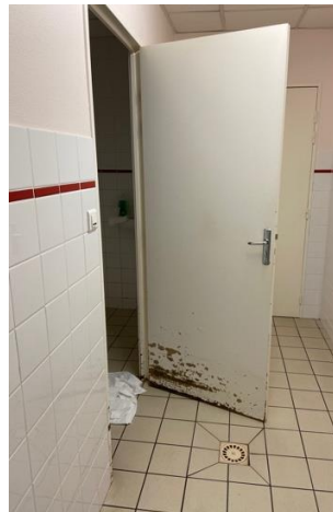
Porte de la douche pour les chambres de surveillance
