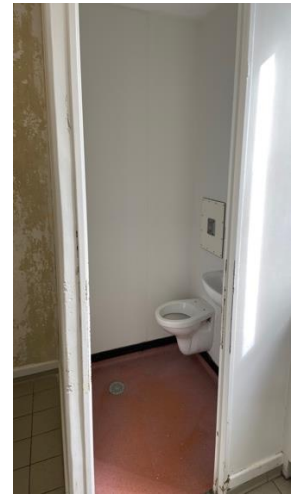
Toilettes dans la chambre de surveillance
