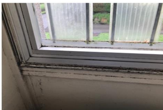
Traces de moisissure aux fenêtres
