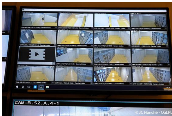
Ecran de contrôle d'un poste de vidéosurveillance du dépôt
