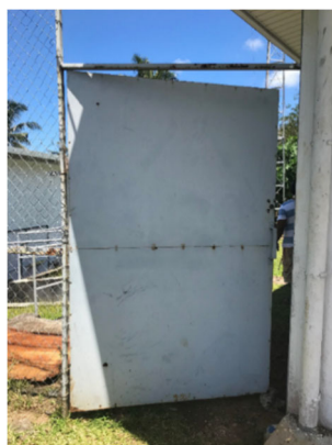
Porte d'entrée inopérante
