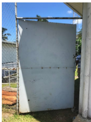
Porte d'entrée inopérante
