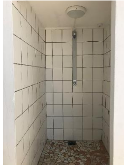
Cabine de douche
