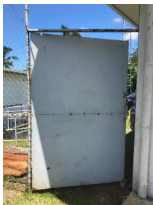
Porte d'entrée inopérante
