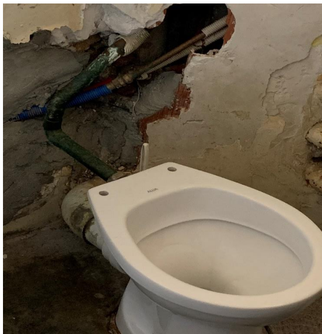
Mur dégradé derrière la cuvette WC
