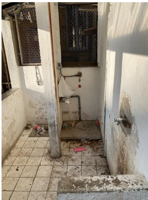
Cour de promenade et toilettes dégradées
