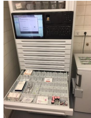
Armoire sécurisée de continuité
