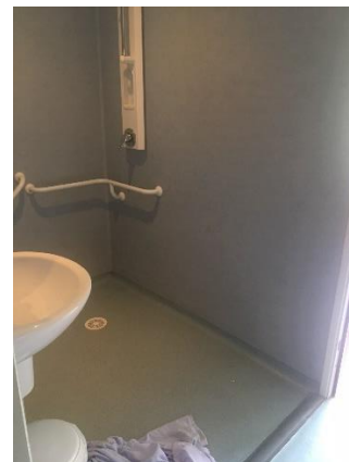
Salle d'eau d'une CI dans le sas d'entrée
