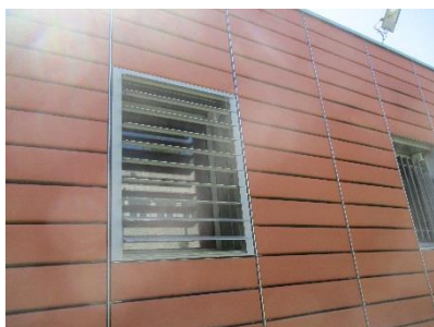
Fenêtre non barreaudée : volets horizontaux bloqués
