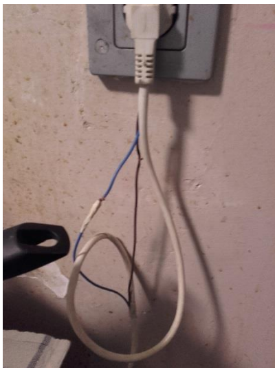
Fil électrique du réfrigérateur, mur tâcheté de graisse
