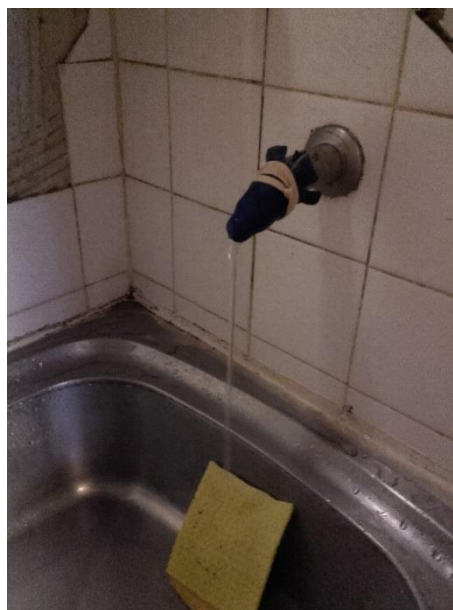
Autre cellule : filet d'eau du robinet qui fuit, éclaboussures limitées par des moyens de fortune
