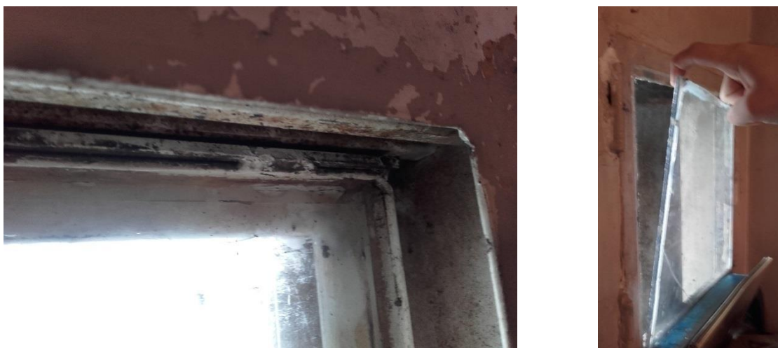
Même cellule du A : encadrement de fenêtre secondaire situé à la tête du lit ; le plexiglas se décolle et laisse passer l'air ; un collage de fortune permet de renforcer l'étanchéité
