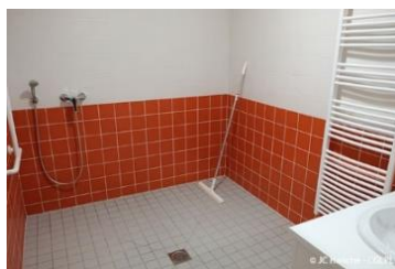
Sanitaire d'un appartement
