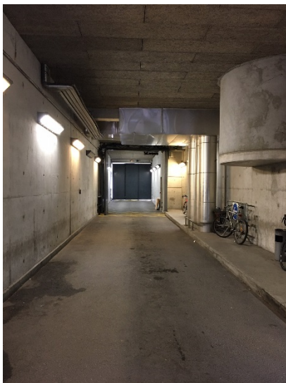
Sas d'entrée des véhicules
