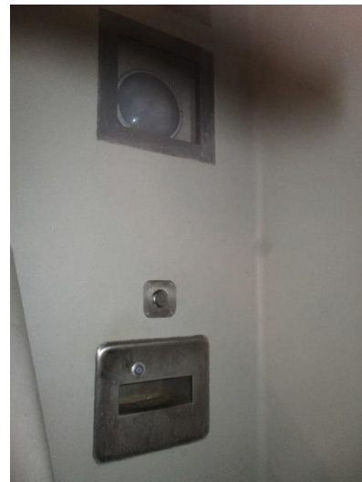
L'éclairage automatique, le point d'eau et la chasse d'eau des cellules uniques
