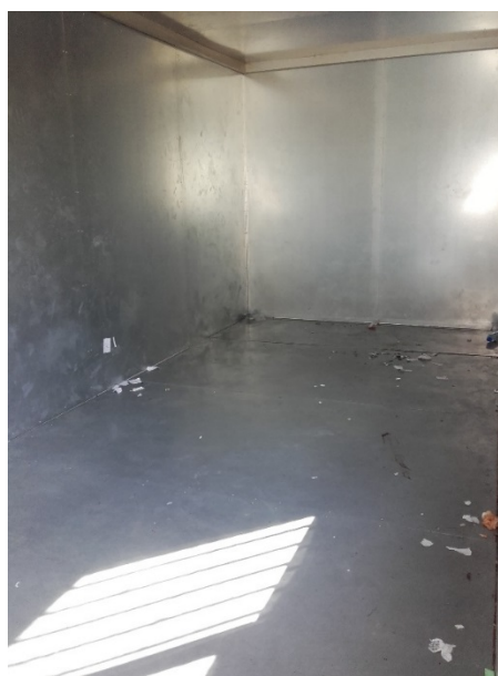
Intérieur des modulaires préfabriqués
