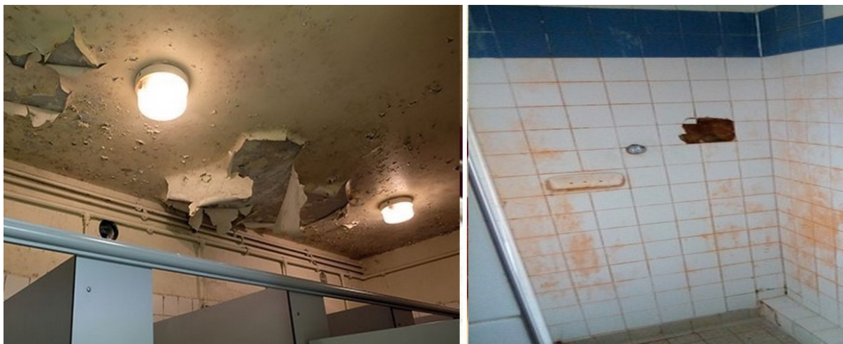
Etat des douches collectives (zone socio et au bâtiment F)
