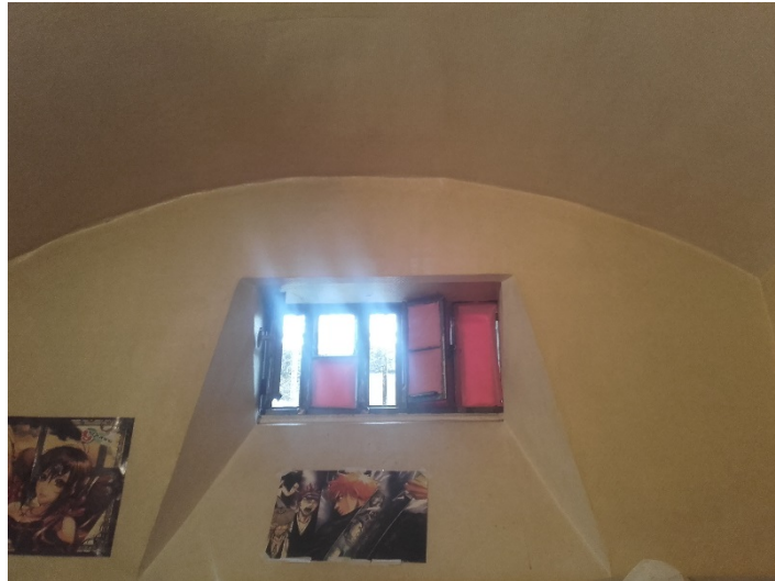
Une fenêtre avec des carreaux cassés
