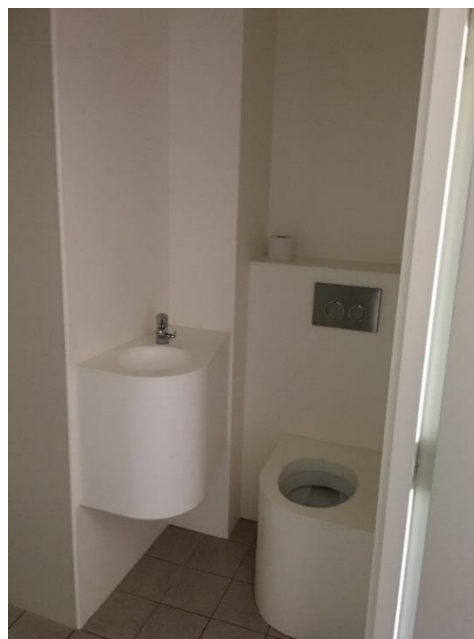
Bloc sanitaire d'une chambre d'isolement
