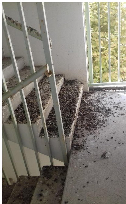
Sortie de secours non entretenue unité Saint-André
