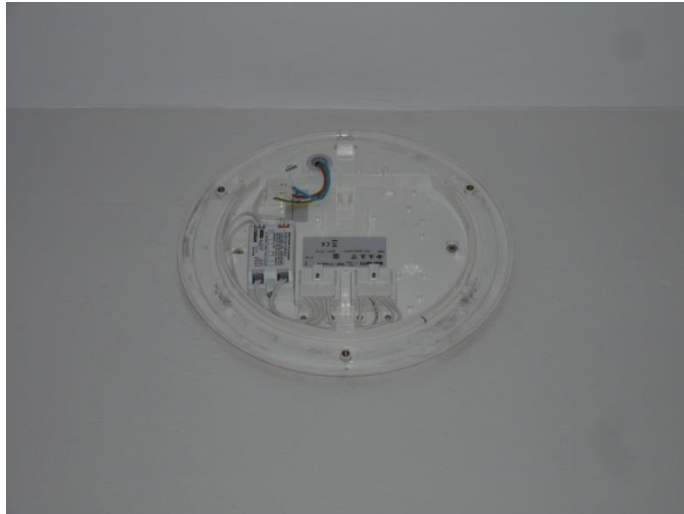
Luminaire défaillant dans la cellule de droite
