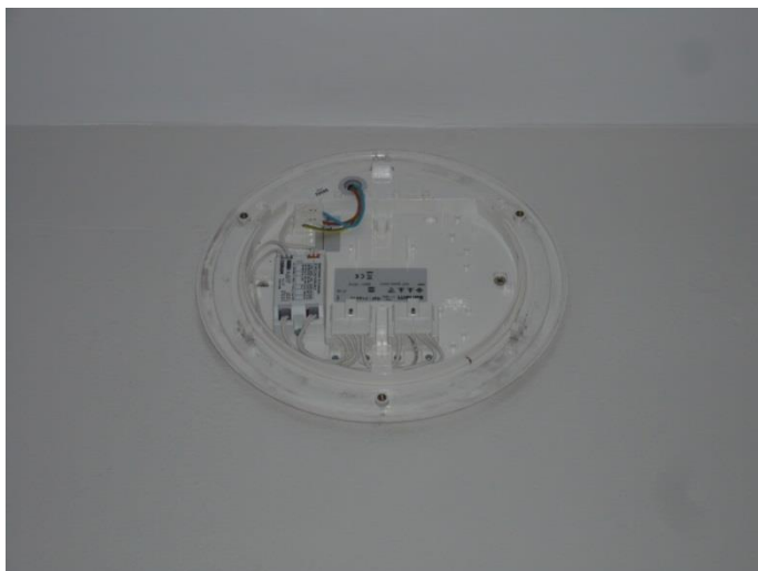
Luminaire défaillant dans la cellule de droite
