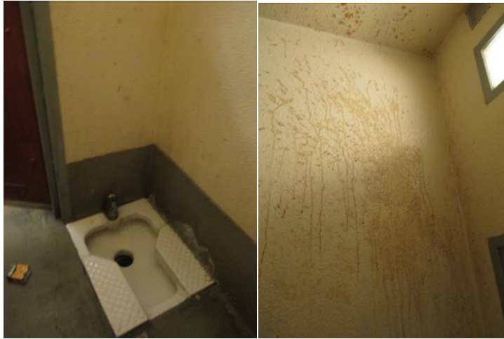
Le WC à la turque et les souillures aux murs
