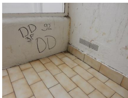
Graffiti et traces de moisissures
