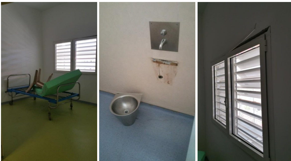
La chambre détériorée
