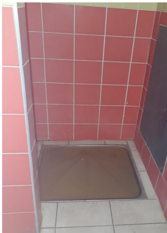
Eau stagnante dans une douche à l'issue de la prestation de ménage quotidienne
