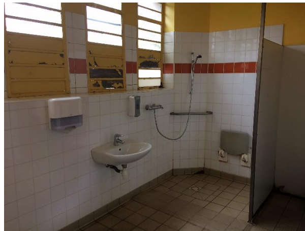
L'une des deux salles d'eau communes de l'unité « Le Tremplin »
