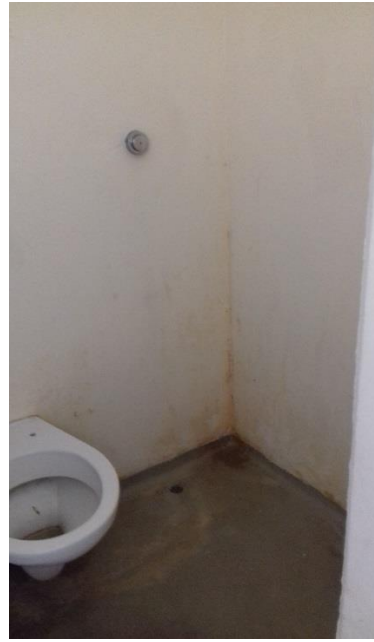
Sanitaires d'une cellule
