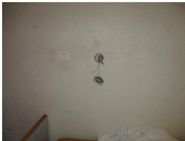
Une prise électrique dans une chambre
