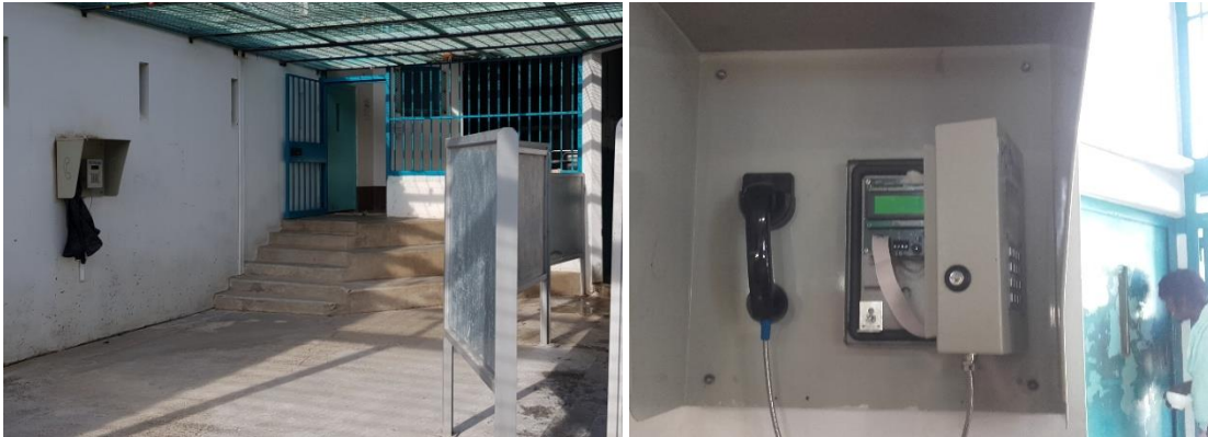
Poste téléphonique dans une courette du quartier MAH1 – Cabine inutilisable dans une UV du CD1
