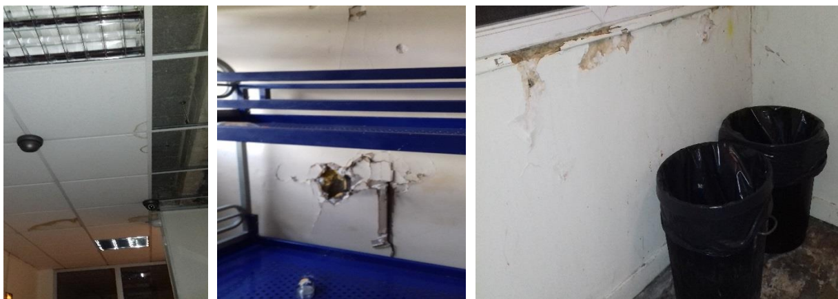
Plafond du réfectoire, une chambre en travaux au 3 ème étage et le hall du 1 er étage près des douches
