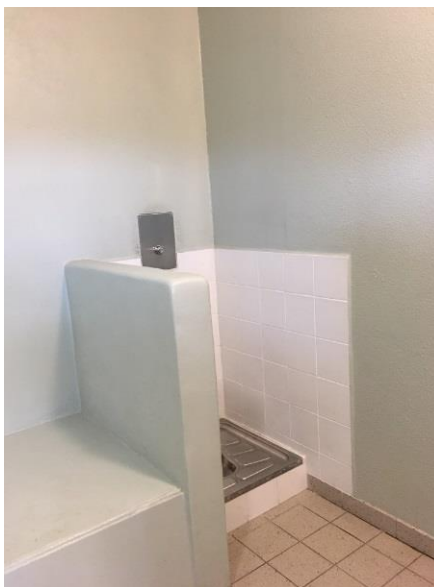
Extrémité droite du socle ciment et toilettes, salle de mise à l'isolement
